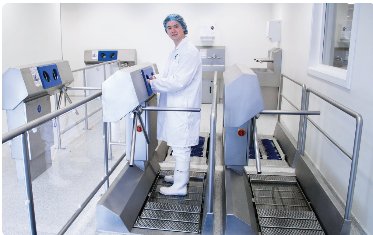
Le DZD-HDT-1000-R, intégré et raccordé à une alimentation centralisée de produits chimiques.
