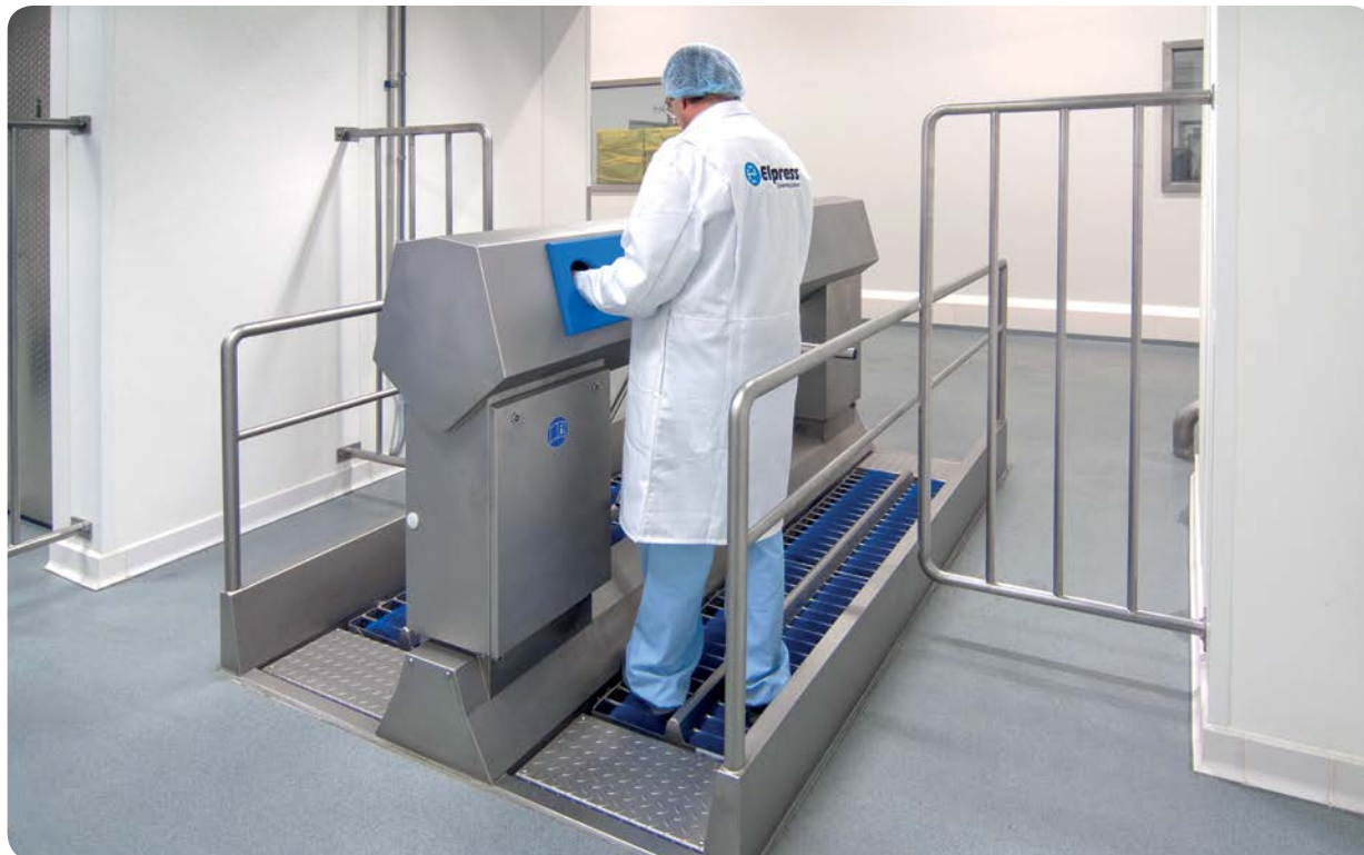
COMBI-BB-DD-1500, model zabudowany w posadzce i podłączony do centralnego system podawania chemii.
